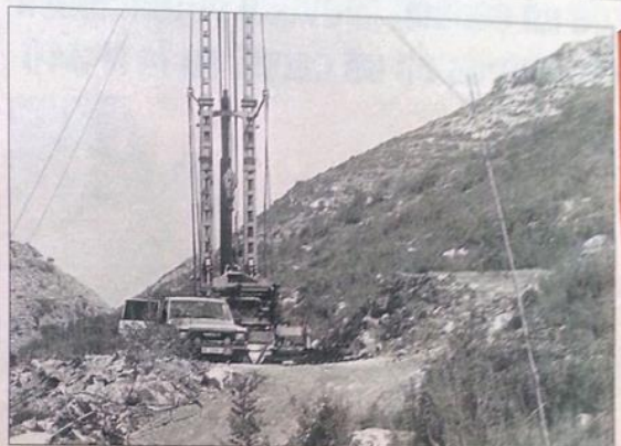
Obras en la Font de la Parra para suministrar agua sin nitratos a Carcaixent. VICENT M. PASTOR
